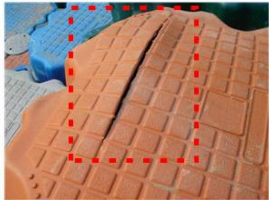
- 플로트 상판 균열
